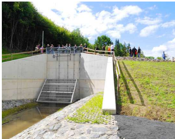
Durchlassbauwerk und Stahlrechen
